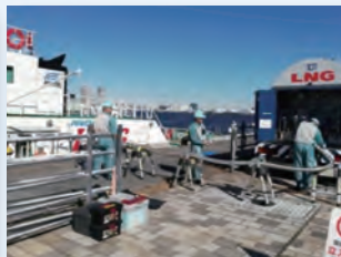
Landside LNG bunkering
