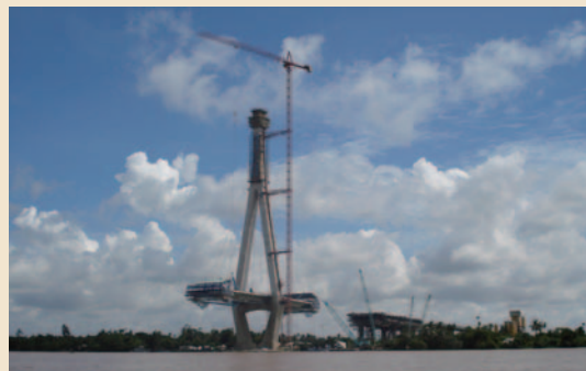
カン トー 市 渡 河 橋 の 橋 脚 建 設 に 使 用 さ れ た タ ワ ー ク レ ー ン
